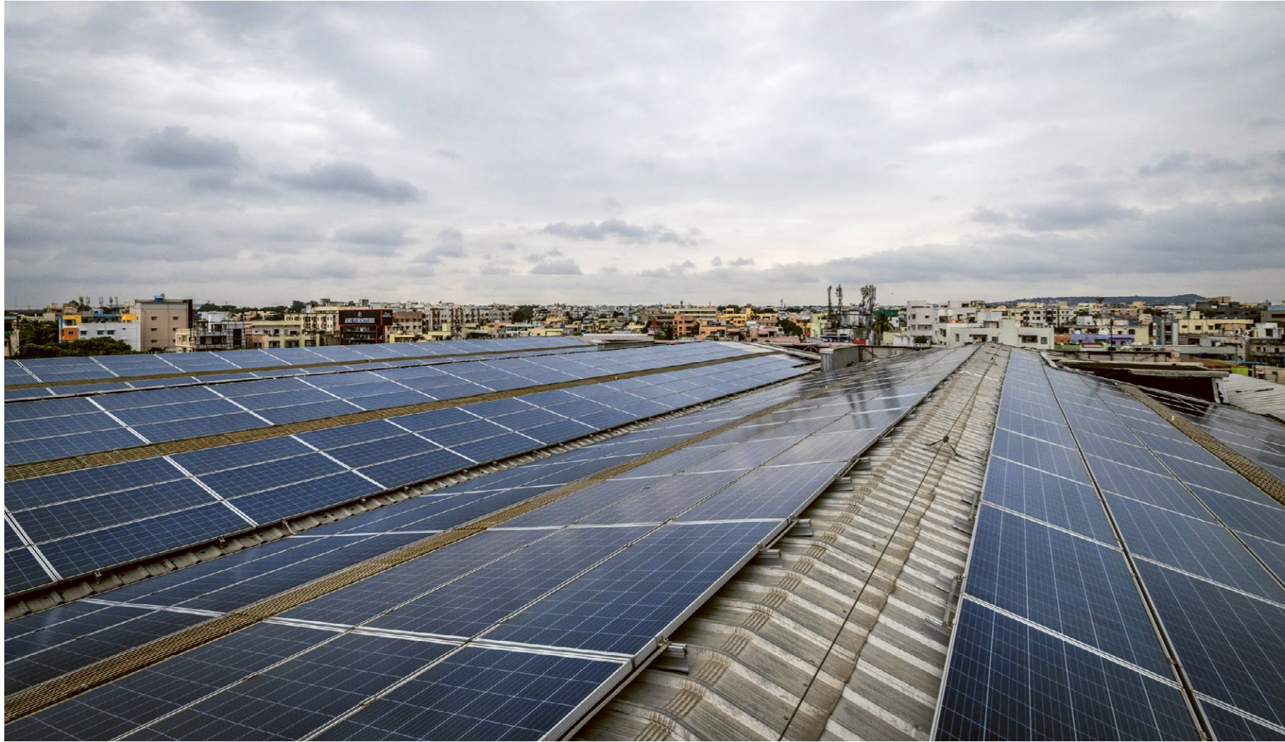
Etliche Themen, die bei der ethischen Geldanlage zu beachten sind, sind relativ eindeutig, wie die Förderung von Solarenergie. Das Foto zeigt eine Photovoltaikanlage auf dem Dach eines Supermarkts in Hyderabad, Indien, die vom Oikocredit-Partnerunternehmen Fourth Partner Energy betrieben wird.
